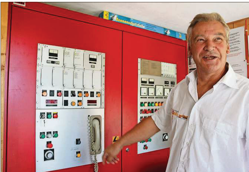
Rico Camen am Schaltschrank der Bergstation.
